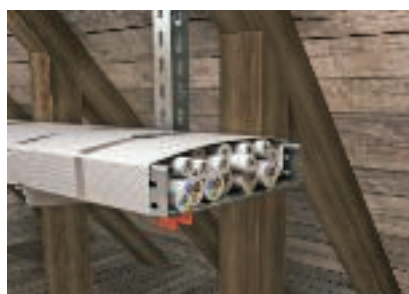
Kabelové nosné systémy opatřené bandážemi v prostorách s velkým množstvím hořlavých materiálů
