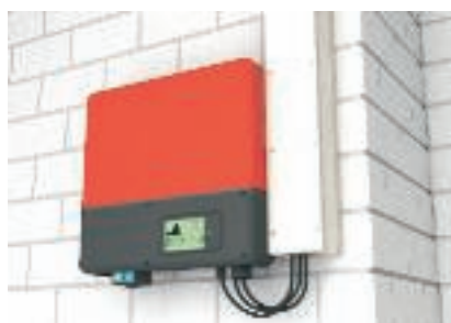
Ochrana proti nebezpečnému dotyku začíná hned u měniče
