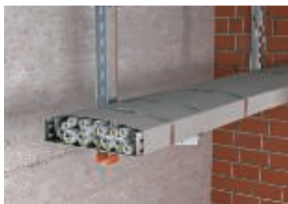
Úplné ovinutí zavěšené kabelové trasy
