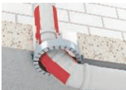
Trubková hrdla v prostoru vstupu
