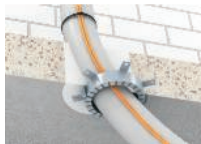
Rozvod potrubní pošty se dvěma současně procházejícími kabely
