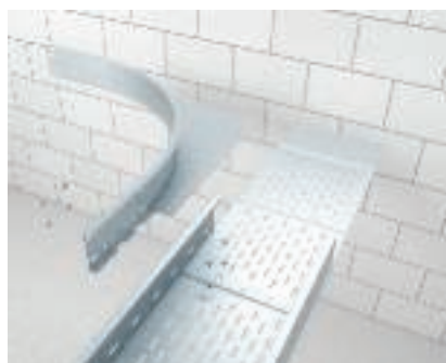
Zhotovení odbočného dílu T pomocí rohového vestavného dílu Montáž prvního rohového vestavného dílu typu WEAS 110.
