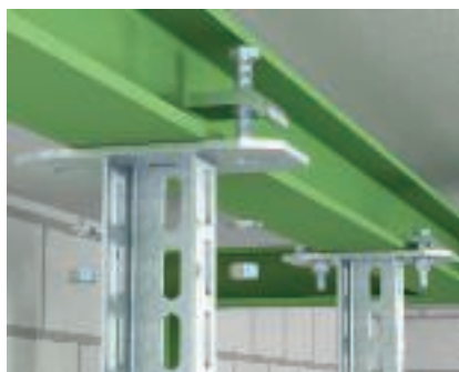
Použití na vodorovném ocelovém nosníku Svěrná upevnění úhlovými svorkami a upínacími svorkami k vodorovně probíhajícímu ocelovému nosníku.
