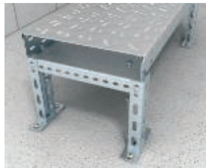
Použití podpěry Montáž a upevnění pochozího systému kabelových žlabů při umístění na podlaze.
